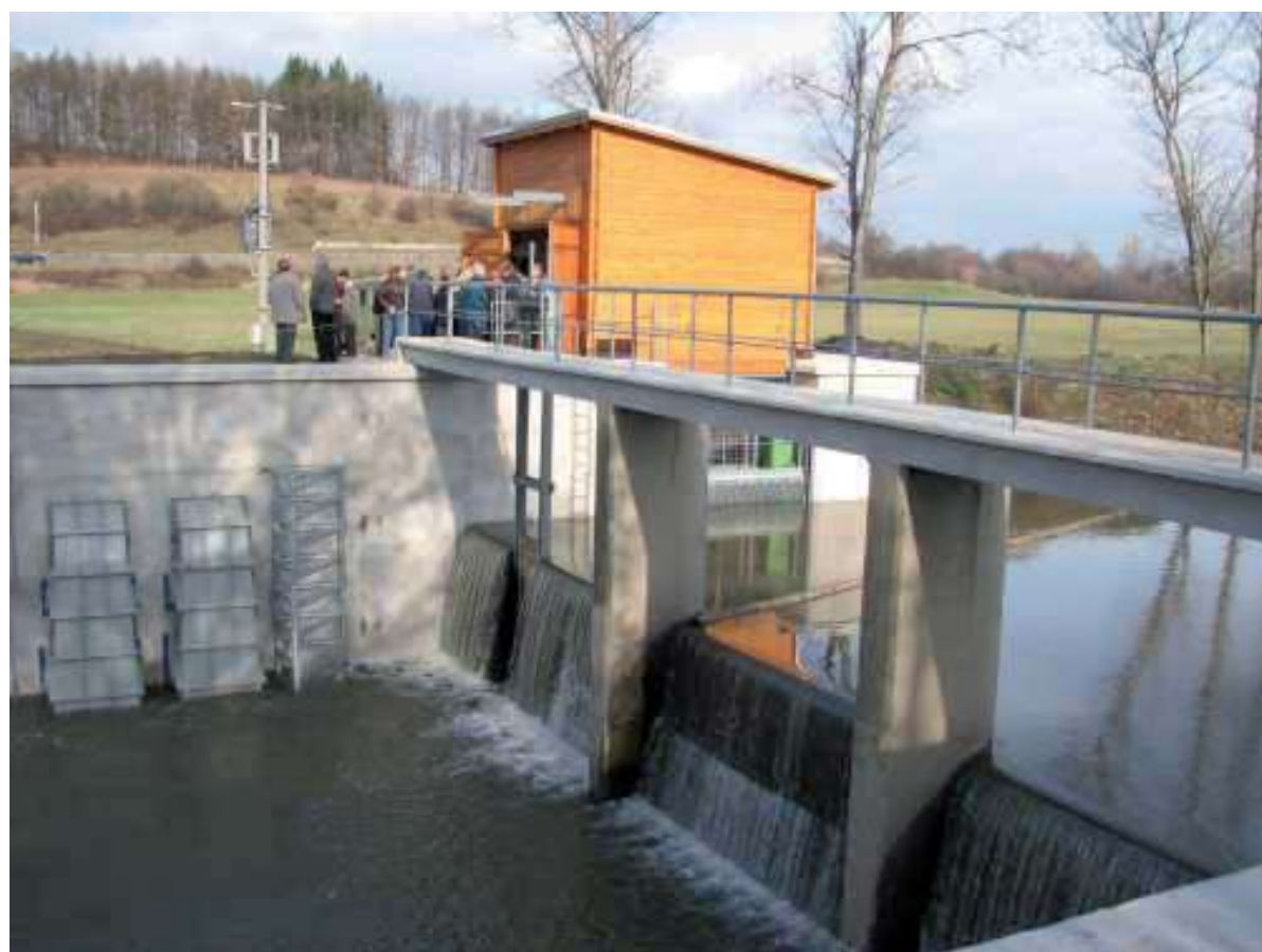
MALÁ VODNÍ ELEKTRÁRNA V OBCI BOHUSLAVICE NAD VLÁŘÍ
