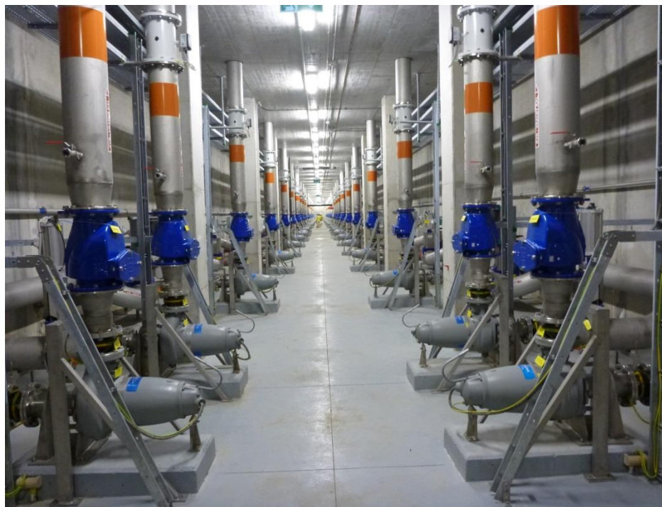
ÚČOV Praha - NVL Čerpací stanice vratného kalu z DN
